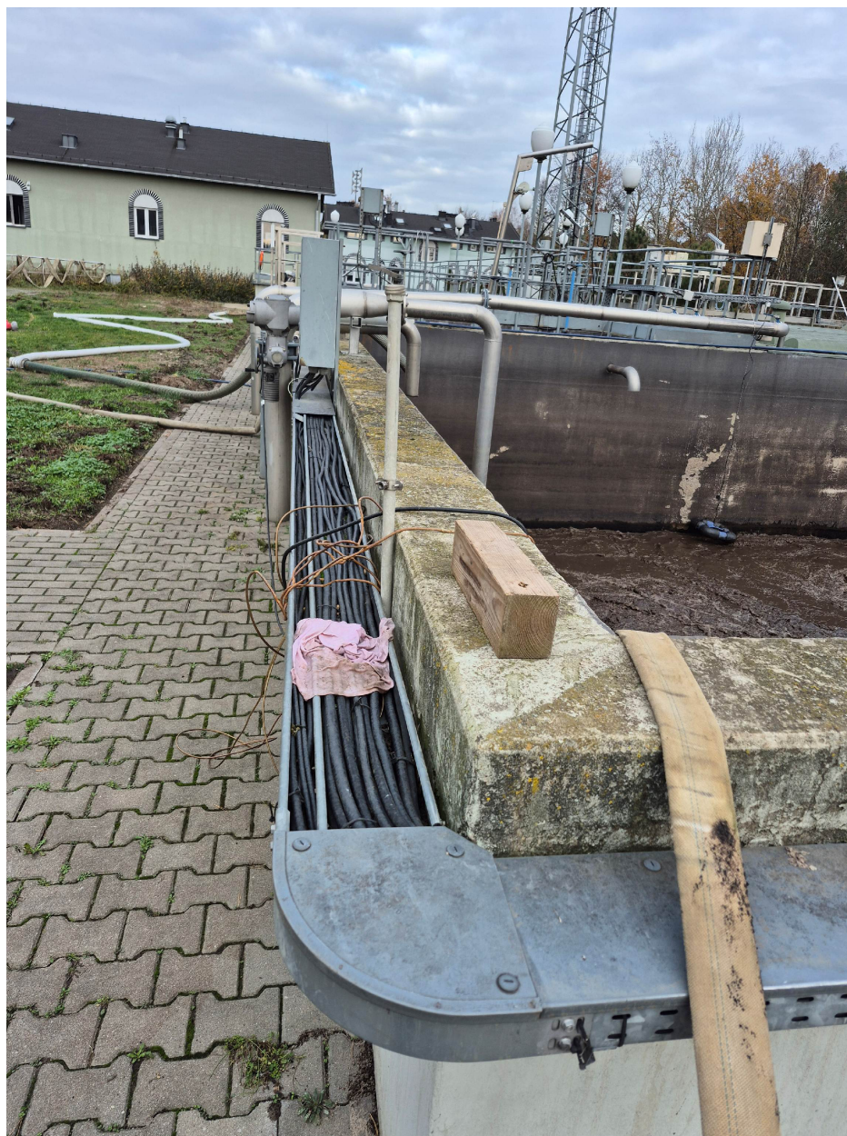
Fot. 3 Zdjęcie korony KTSO – widok od strony doprowadzenia instalacji sprężonego powietrza
