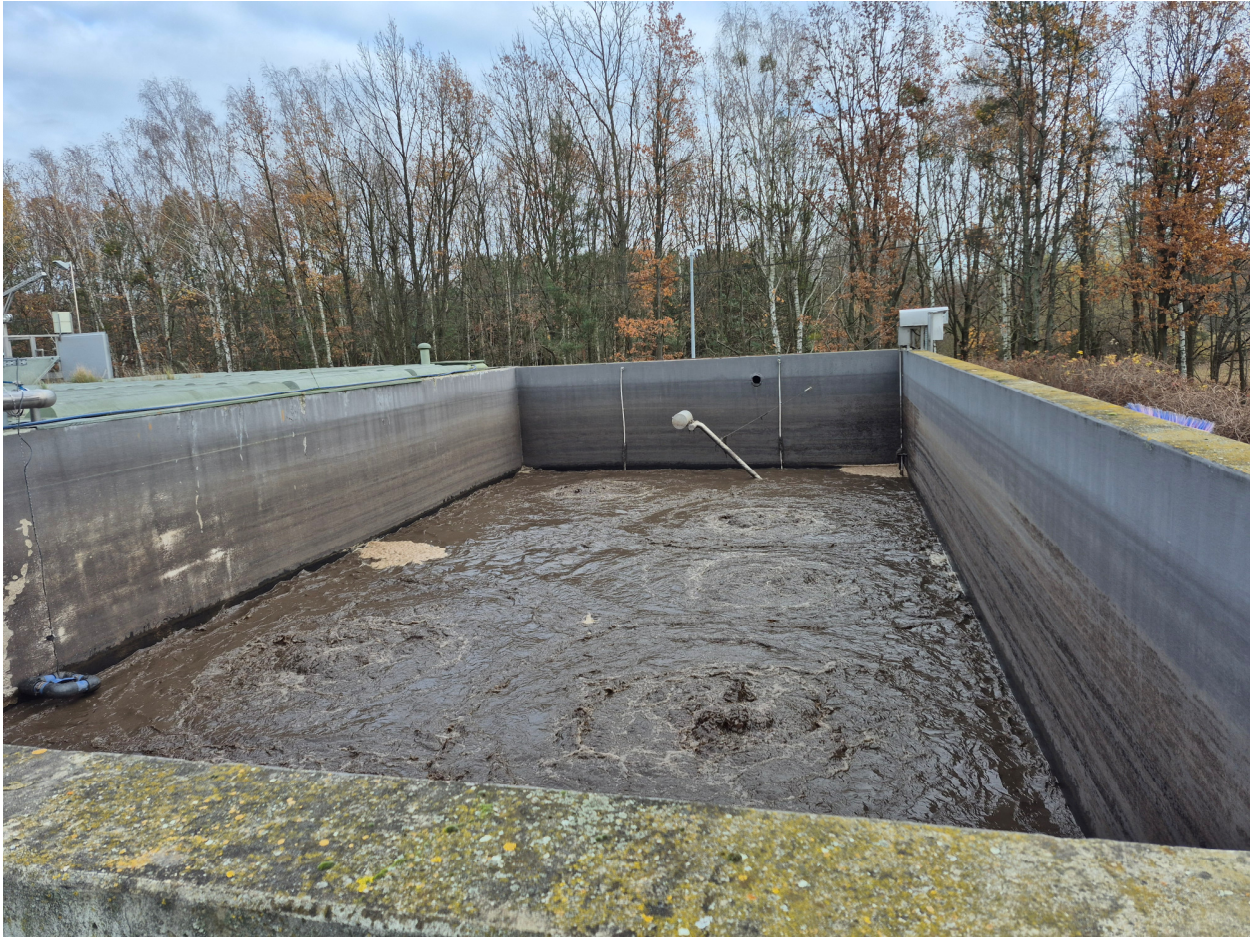
Fot. 2 Zdjęcie zbiornika KTSO
