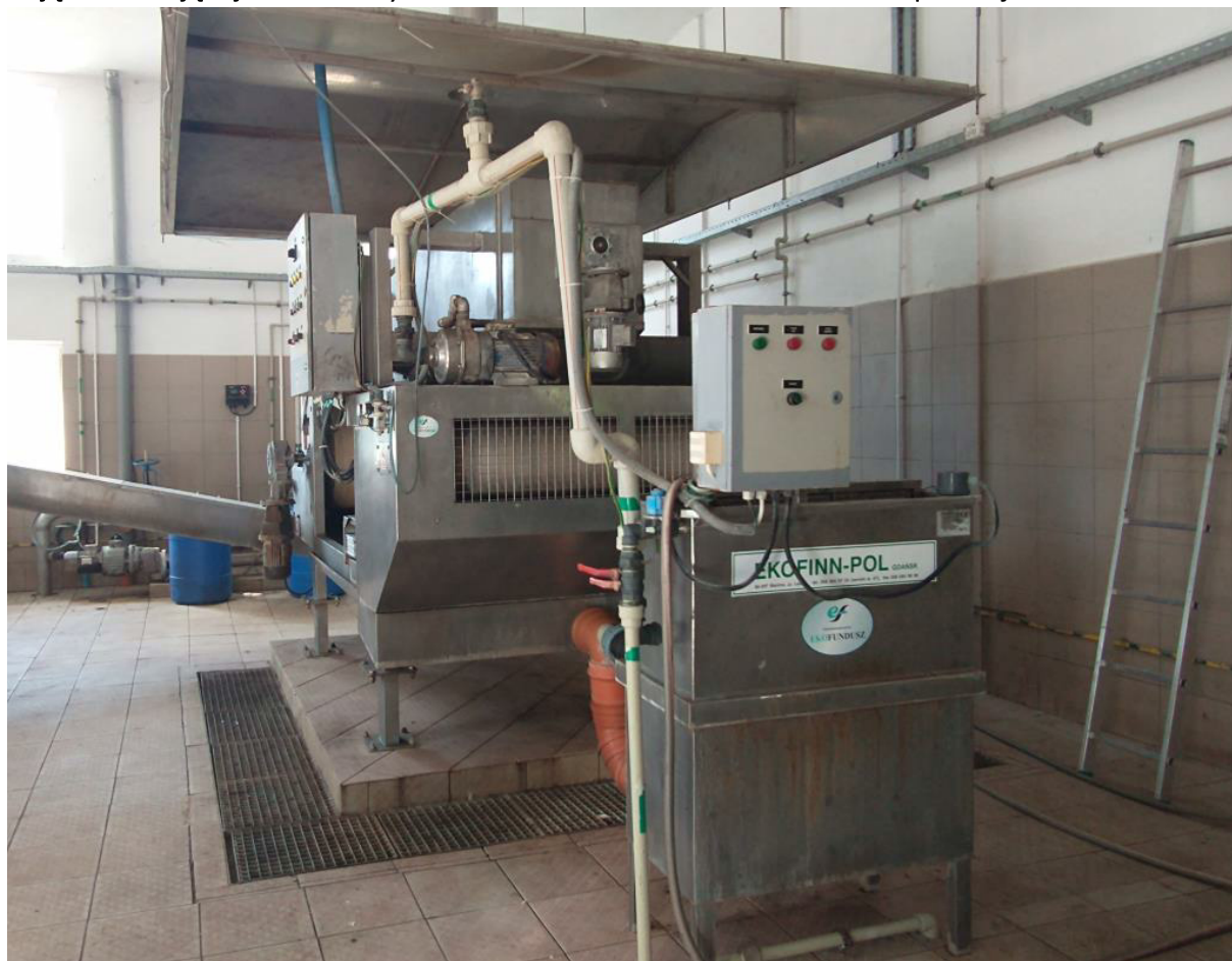
Zdjęcie 1 Istniejąca instalacja odwadniania osadów
