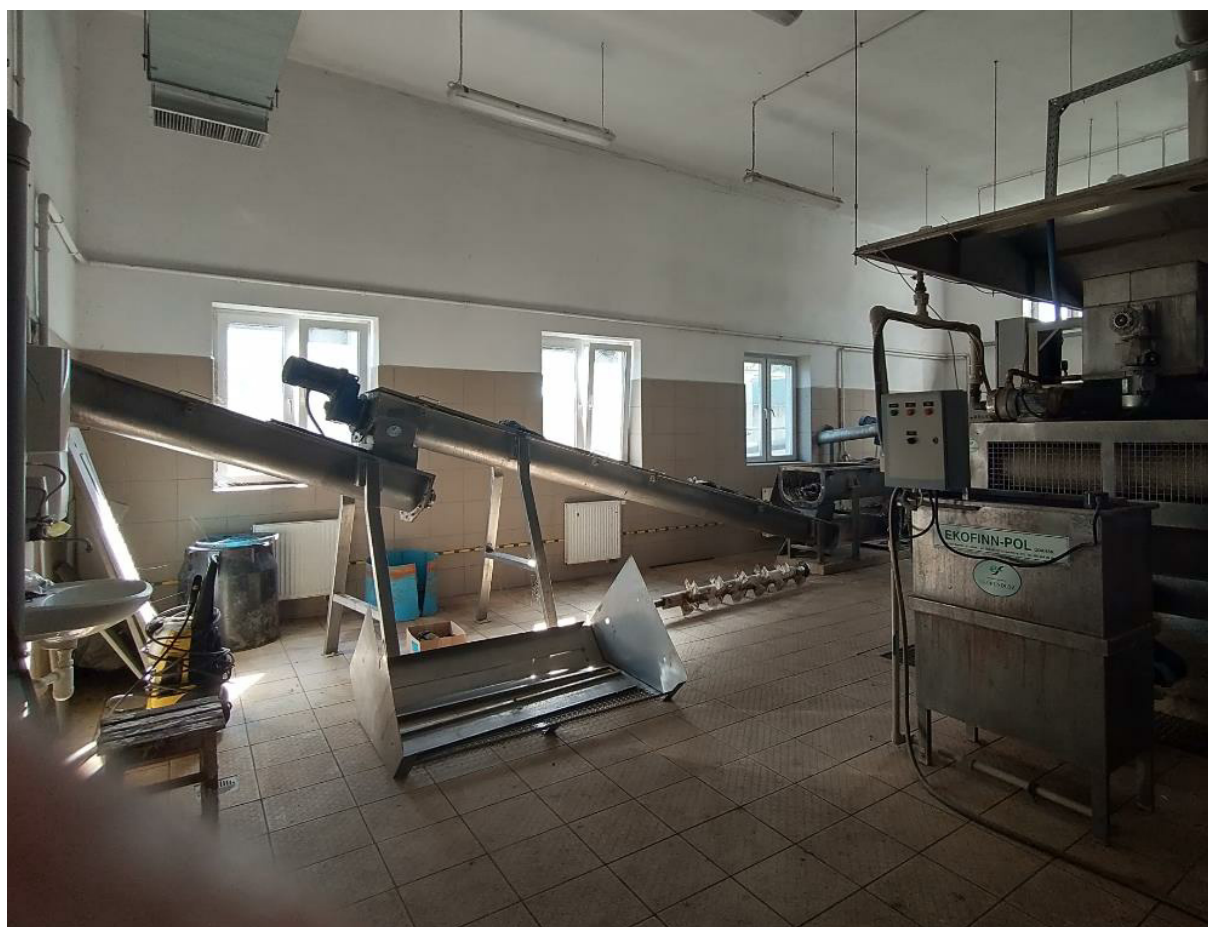
Zdjęcie 2 Instalacja ewakuacji osadów odwodnionych
