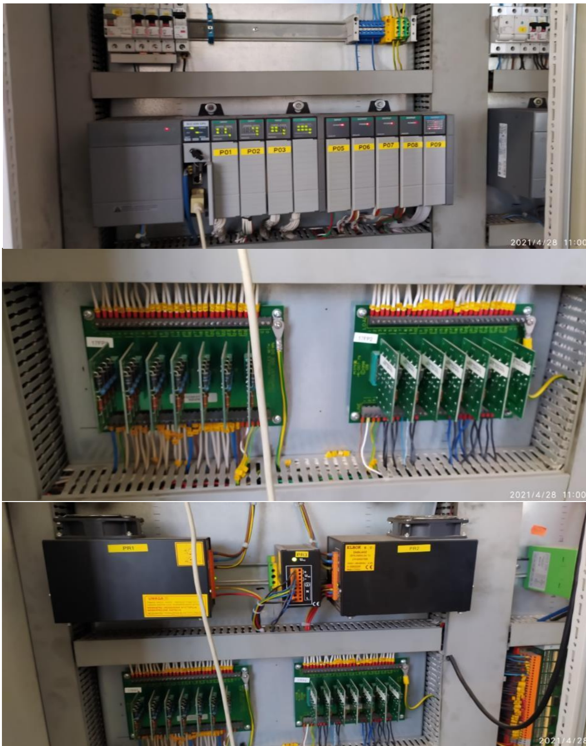
Zdjęcie 29 Widok wnętrza szafy GS17 – płyta montażowa ze sterownikiem, zasilaczami oraz modułami przyłączeniowymi I/O
