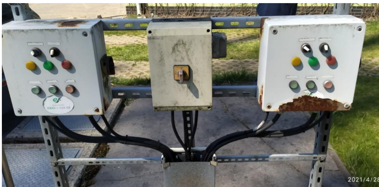
Zdjęcie 11 Szafki układu pomiarowego i regulacyjnego w komorze dopływowej
