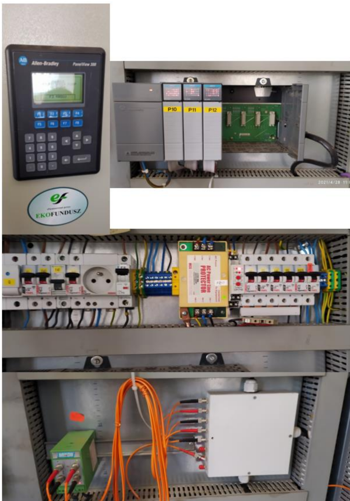
Zdjęcie 30 Widok wnętrza szafy GS17 – panel HMI na elewacji, osprzęt światłowodowy, aparatura łączeniowa oraz wyspa I/O
