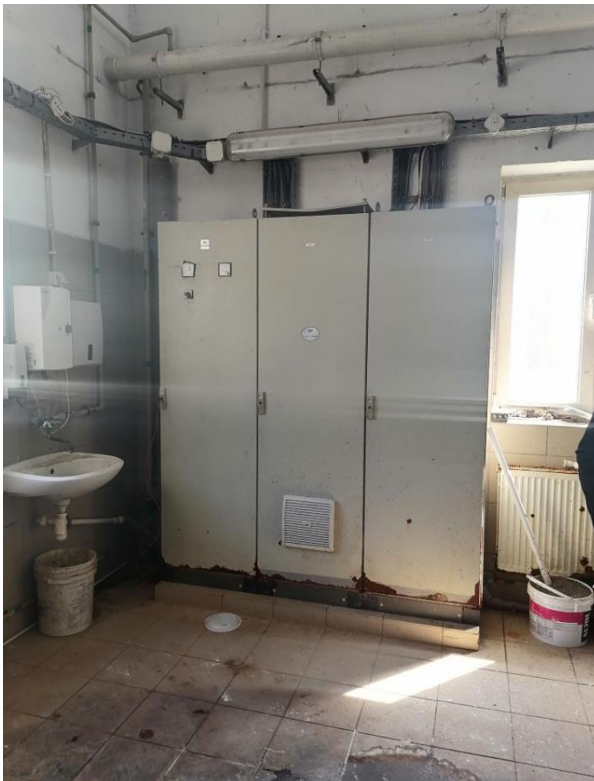
Zdjęcie 36 Szafy obiektowe w budynku wielofunkcyjnym
