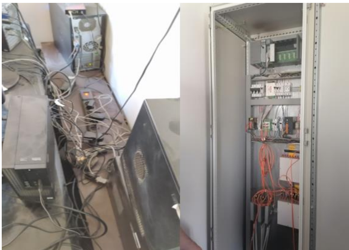
Zdjęcie 14 Sprzęt komputerowy do obsługi systemów monitoringu oraz szafa PiA18 w pomieszczeniu dyspozytorski
