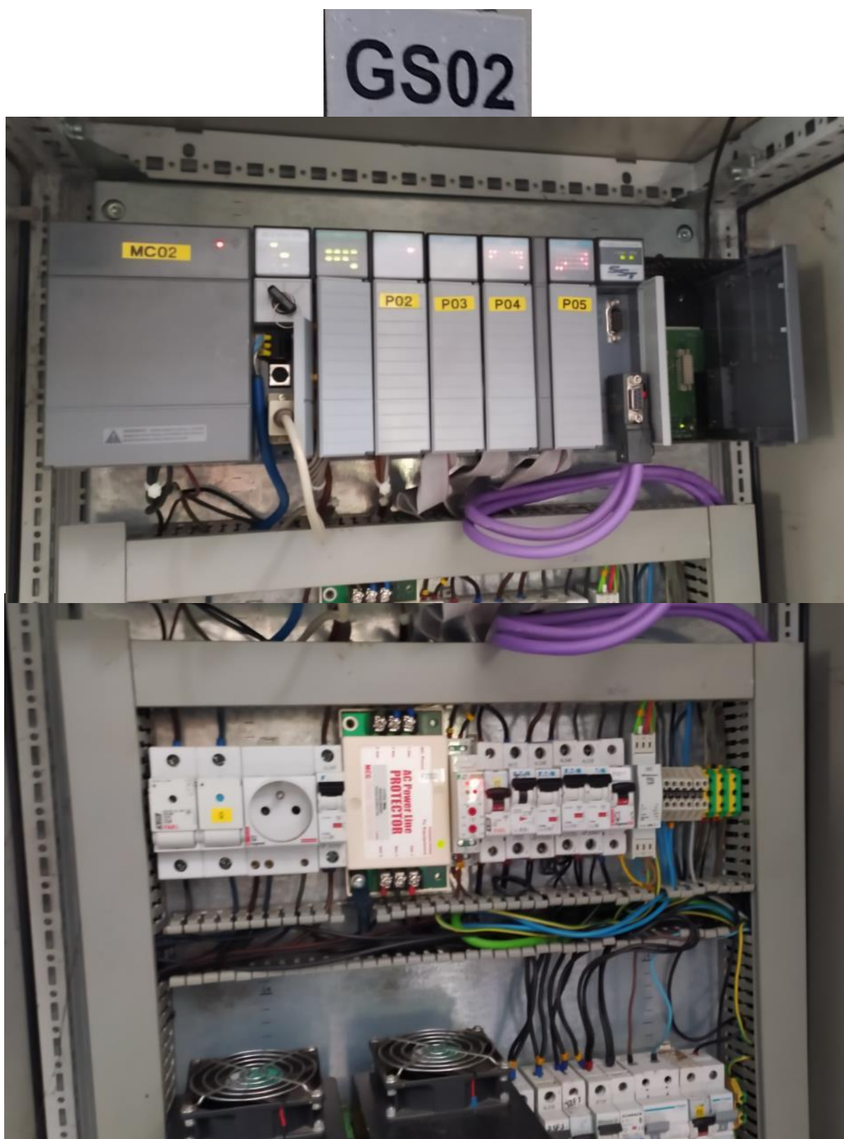
Zdjęcie 17 Widok wnętrza szafy PiA GS02 – płyta montażowa ze sterownikiem oraz aparaturą łączeniową
