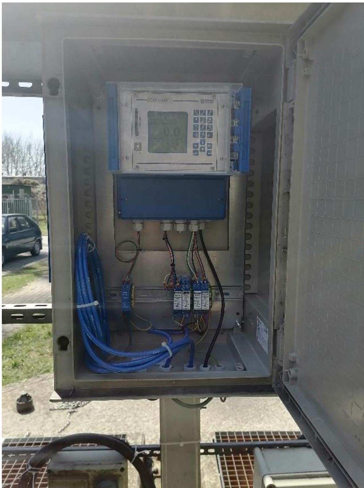
Zdjęcie 10 Układ pomiaru ścieków surowych dopływających do oczyszczalni
