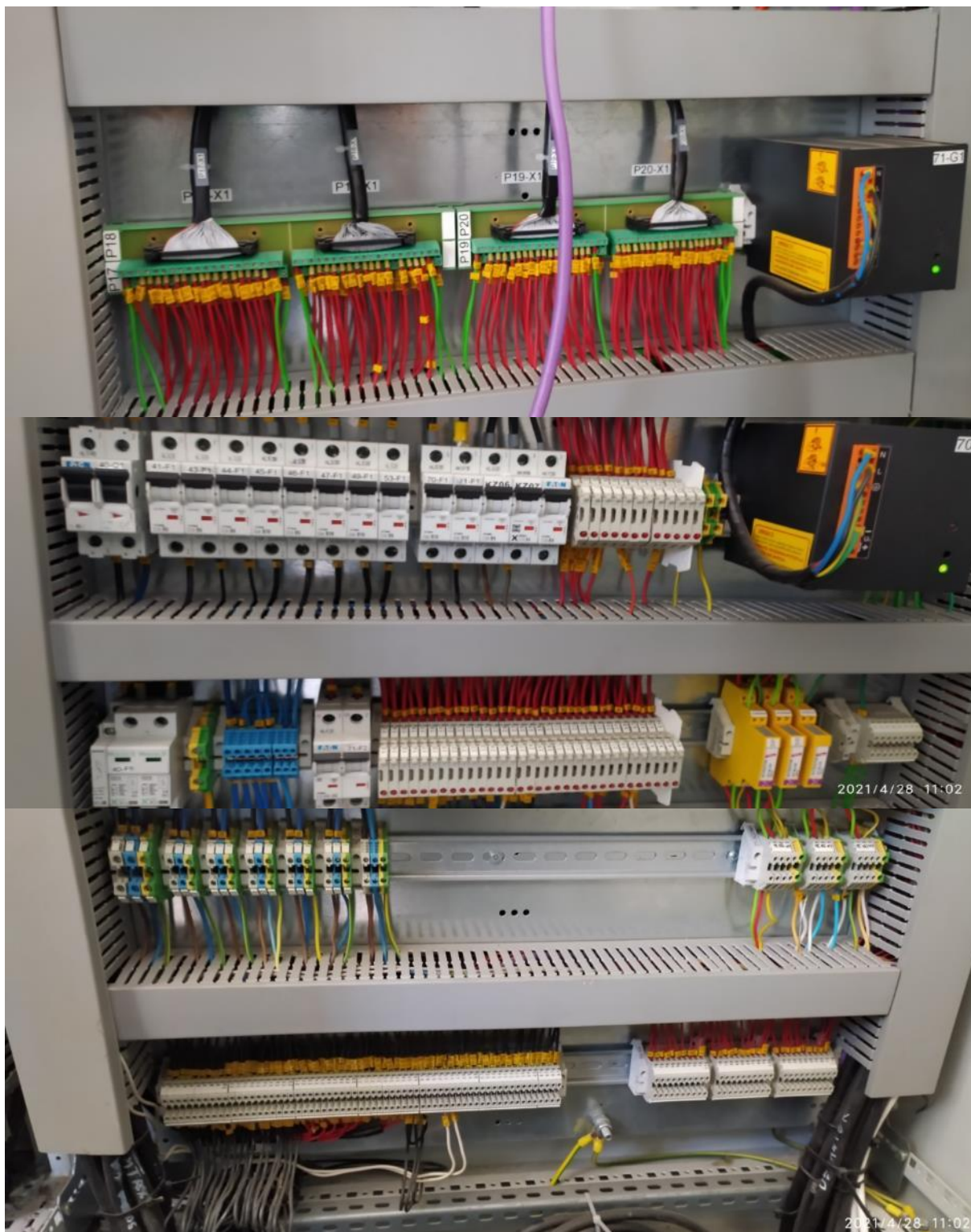
Zdjęcie 33 Widok wnętrza szafy GS17 – Pole 2 - płyta montażowa z modułami przyłączeniowymi I/O, aparaturą łączeniową oraz złączkami
