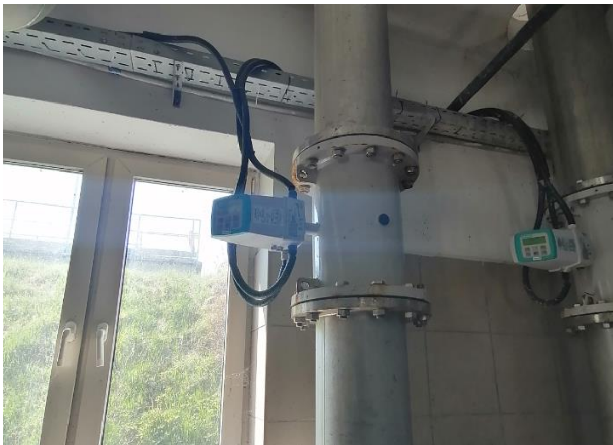
Zdjęcie 40 Układ pomiaru przepływu w budynku oczyszczania mechanicznego
