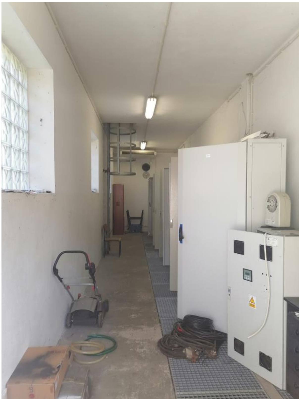
Zdjęcie 35 Widok pomieszczenia rozdzielni głównych
