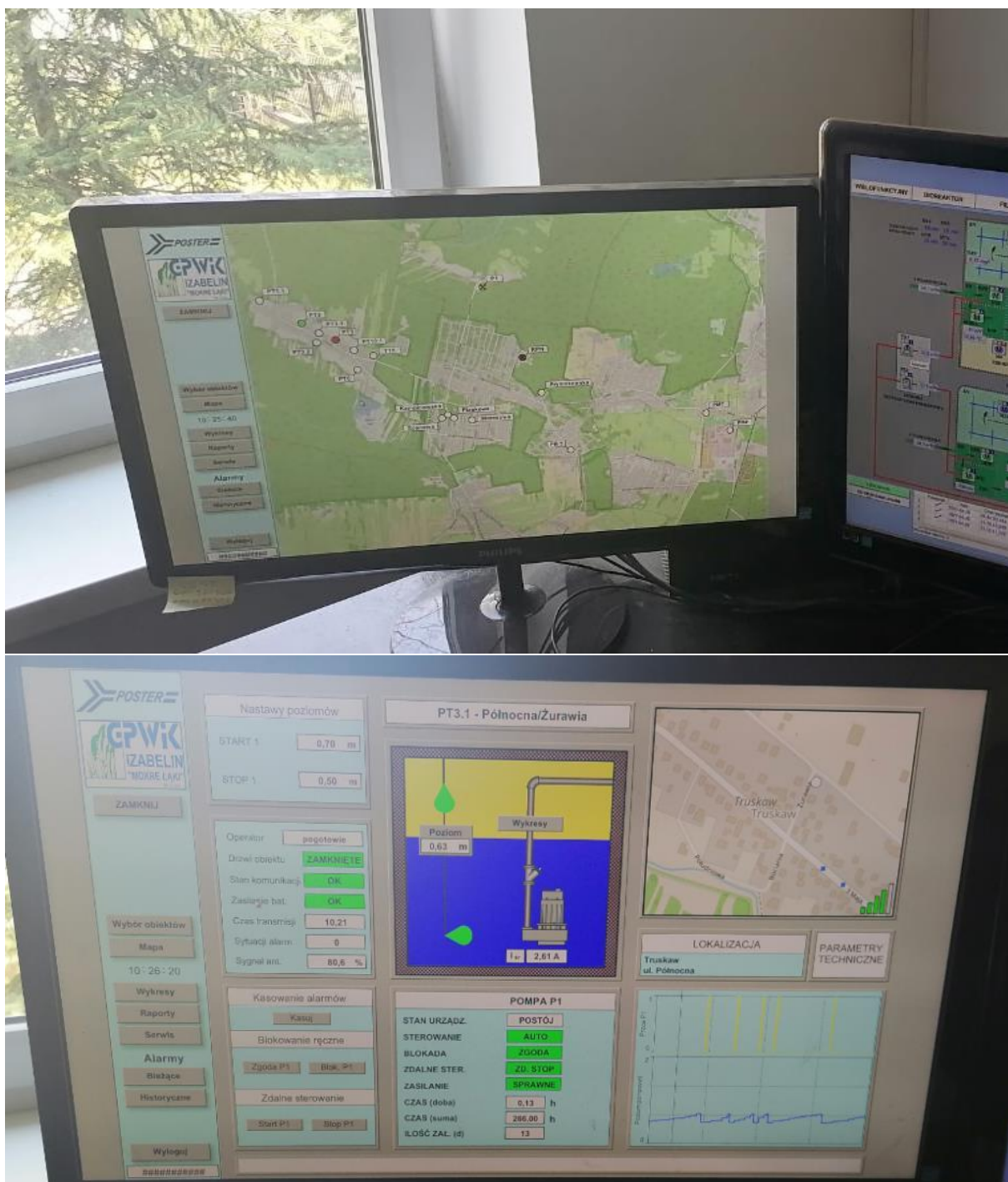
Zdjęcie 37 System monitoringu pompowni ściekowych POSTER
