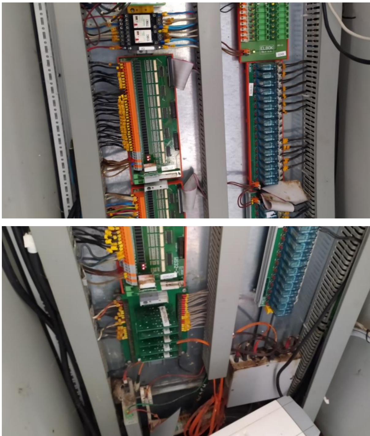
Zdjęcie 19 Widok wnętrza szafy PiA GS02 – płyta montażowa z listwami przyłączeniowymi modułów I/O oraz przetwornicą FO
