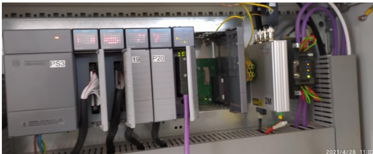
Zdjęcie 32 Widok wnętrza szafy GS17 – Pole 2 - płyta montażowa ze sterownikiem
